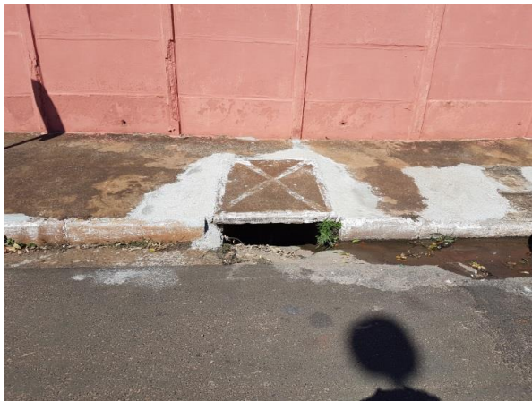
Foto 3.12 – Estrutura de microdrenagem insuficiente
