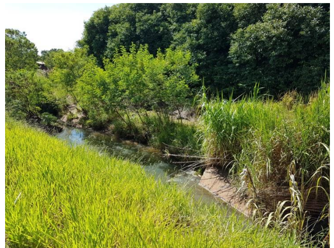
Foto 3.21 – Canal a céu aberto com necessidade de manutenção da estrutura
