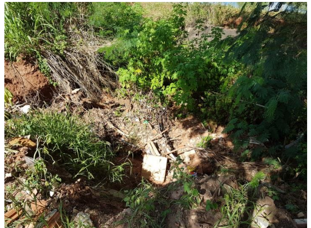
Foto 3.23 – Erosão causada pelo escoamento superficial
