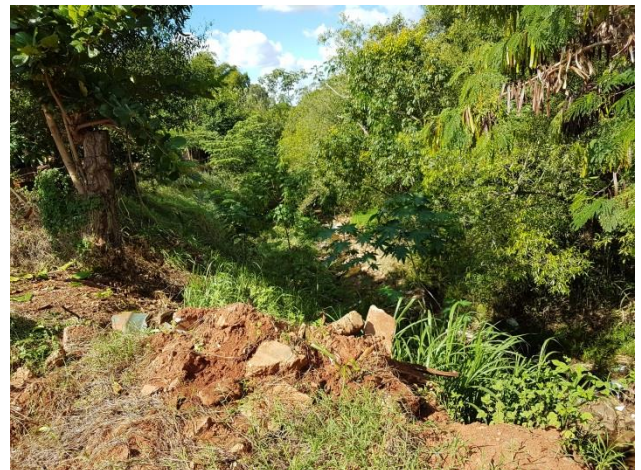
Foto 3.25 – Erosão causada pelo escoamento superficial
