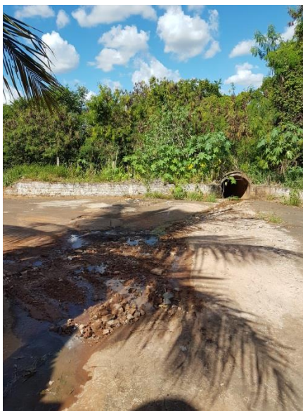
Foto 3.26 – Erosão causada pelo escoamento superficial
