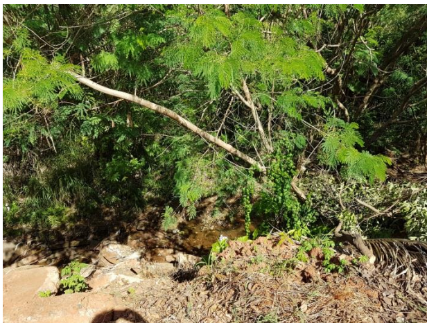
Foto 3.24 – Erosão causada pelo escoamento superficial
