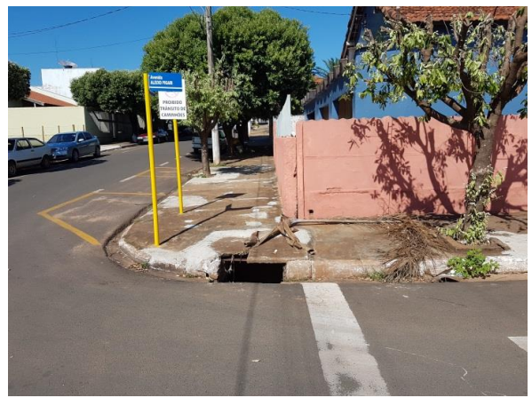
Foto 3.13 – Estrutura de microdrenagem insuficiente
