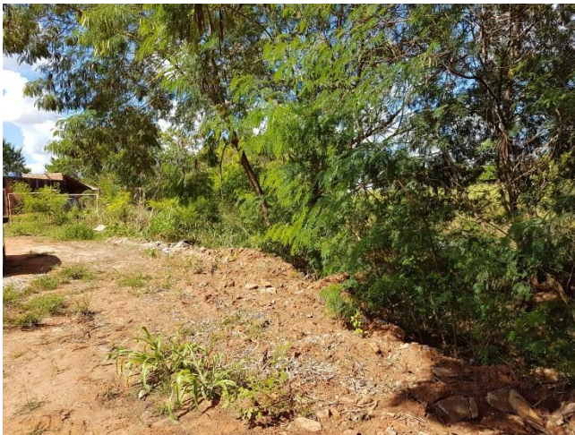
Foto 3.22 – Erosão causada pelo escoamento superficial
