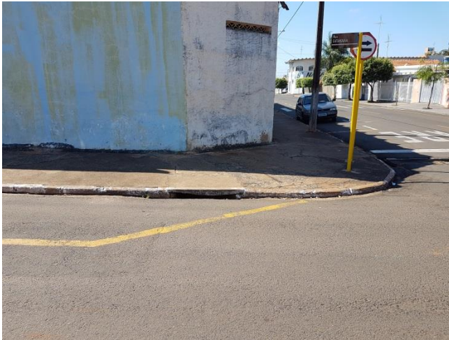
Foto 3.14 – Boca de lobo subdimensionada
