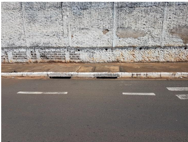
Foto 3.16 – Vista geral da área de alagamento
