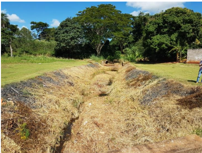
Foto 3.20 – Canal a céu aberto com necessidade de limpeza
